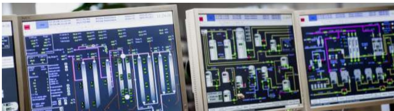
Från kontrollrummet vid Vallviks Bruk, som bemannas av åtta operatörer per skift, styrs tillverkningsprocessen.
