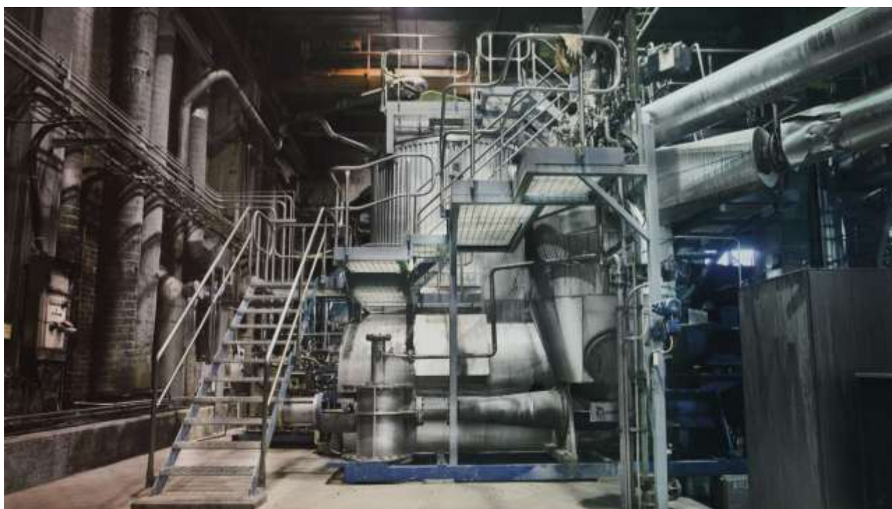
I anläggningen för basning av flis till CTMP-linjen vid Rottneros Bruk bereds vedråvaran innan den mals till massa.
