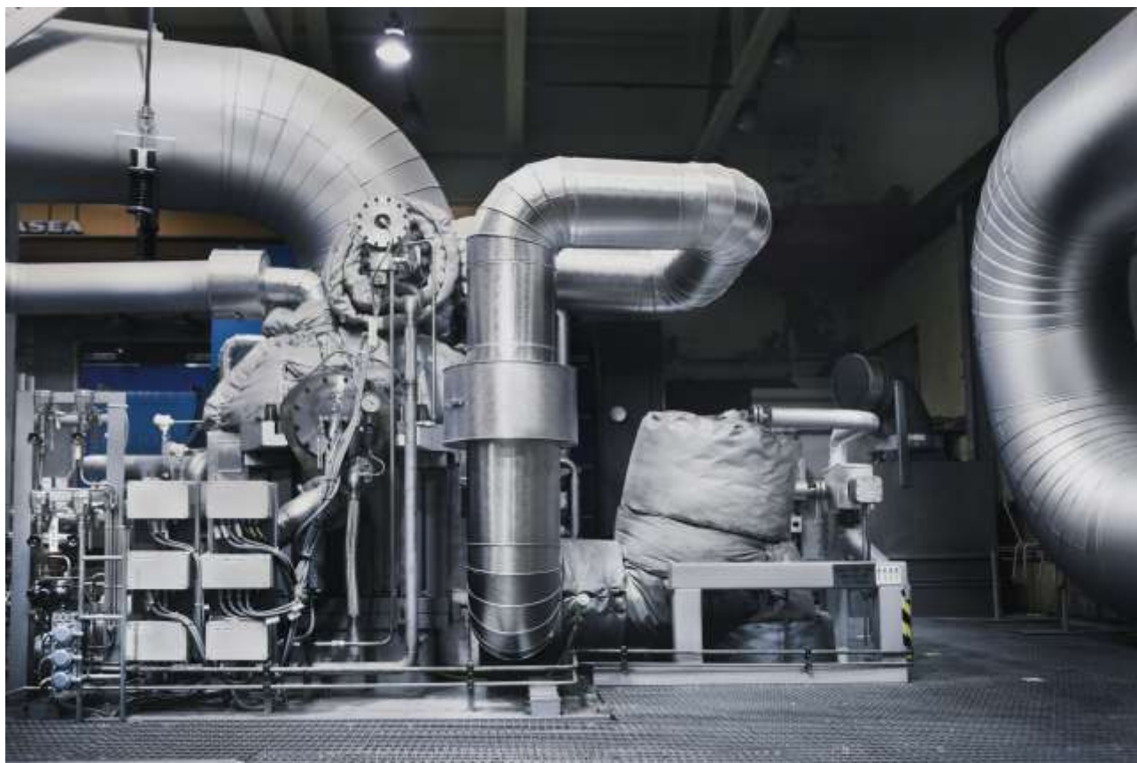
Turbinen i Vallvik producerar cirka 75 procent av den elenergi som bruket använder.
