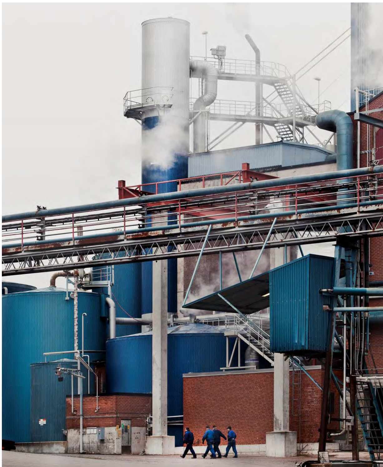
I diffusören vid Vallviks Bruk tvättas massan direkt efter kokningen innan den bleks.
